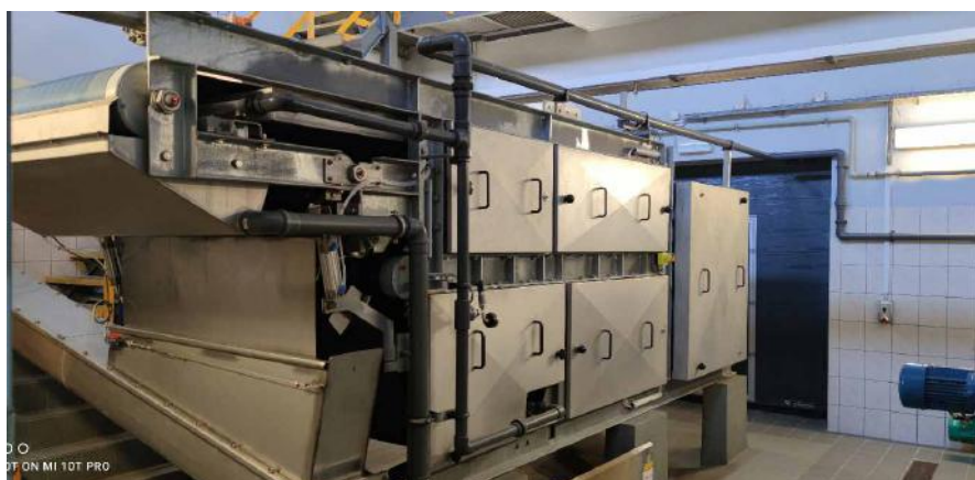
Taśmowa prasa filtracyjna na odwadnianie osadu.
