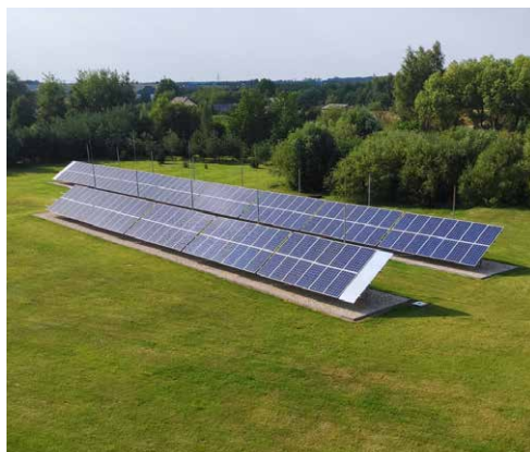
Mikroelektrownia PV na terenie OŚ w Kłobucku
