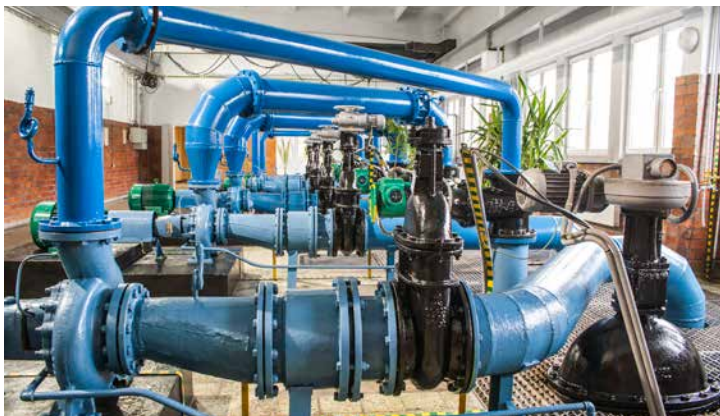
Ujęcie Wody Olsztyn – pompownia
