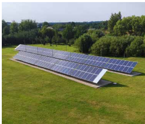
Mikroelektrownia PV na terenie OŚ w Kłobucku
