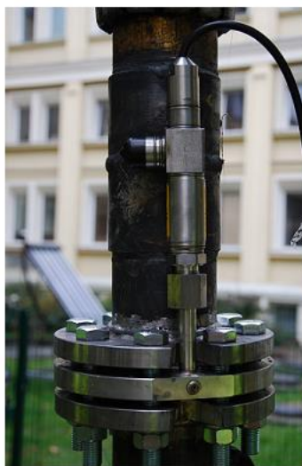
Ryc. 1. Widok na sondę rejestrującą ciśnienia, umieszczoną za króćcem ssawnym pompy głębinowej
