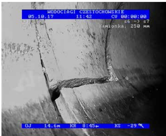
fot. Monitoring wizyjny sieci kanalizacyjnej. Na zdjęciu widoczne pęknięcia wzdłużne i poprzeczne sieci kanalizacyjnej.
