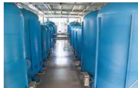
UW Wierchowisko; Stacja Usuwania Azotanów
