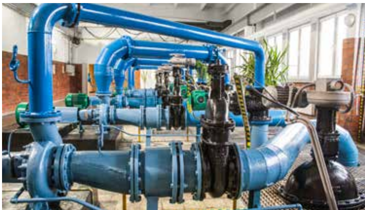
Ujęcie Wody Olsztyn – pompownia
