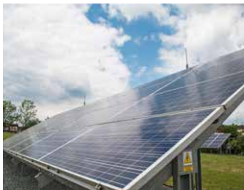
Mikroelektrownia PV na terenie Zbiorników Wody Błesno
