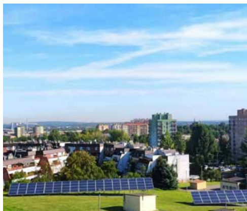
Mikroelektrownia PV na terenie Zbiorników Wody Błęszno
