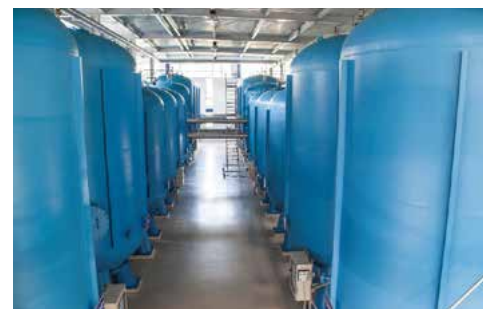
UW Wierchowisko; Stacja Usuwania Azotanów
