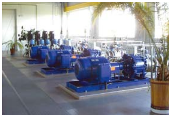
Ujęcie wody Łobodno - pompownia wody
