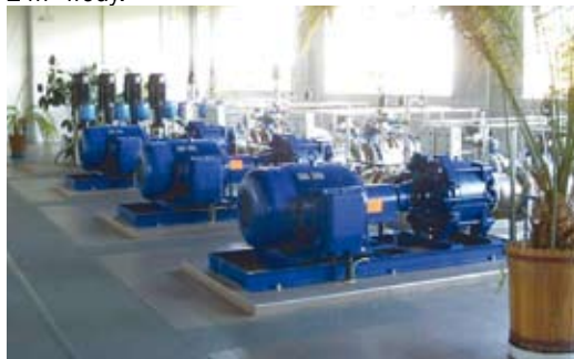
Ujęcie wody Łobodno - pompownia wody
