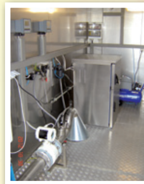
ciąg spustowy wewnątrz kontenera
