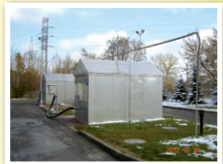
nowe kontenery technologiczne
