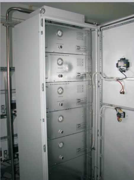
Szafa z generatorami ozonu zainstalowanymi obecnie przez firmę „Wofil”
